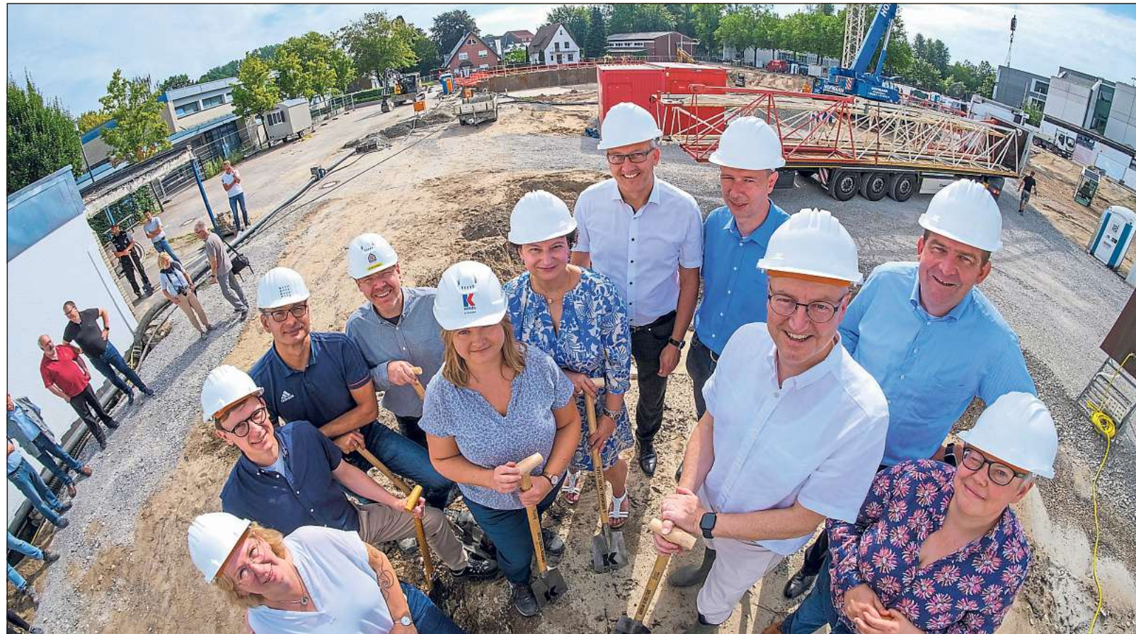
Versammelt auf dem Erdhügel zum Spatenstich (v. l.) Karin Striewe (Stadt Verl), Christian Ptatscheck (Stadt Verl), Thomas Kalman (Krieger Architekten), Marc-André Zander (Fechtelkord & Eggersmann), Katharina Ronicke (Kögel Bau), Dr. Tanja Heinemann (Gesamtschule), Erster Beigeordneter Thorsten Herbst, Sven Schallenberg (Stadt Verl), Bürgermeister Michael Esken (CDU), Lienhard Schulte-Noelle (Constrata) und die Beigeordnete Katrin Vilmar. Fotos: Steinecke
